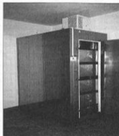
Komora chłodnicza zainstalowana przez „Rezon” w Krakowie.
